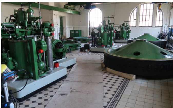
(O74) Strojovna vodní elektrárny, fotografie ze současnosti
